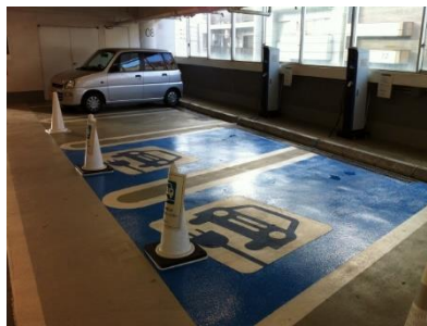
EV充電器設置拡充
